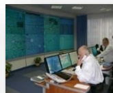
Центр управления сетями
